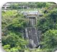
被災した阿蘇大橋
